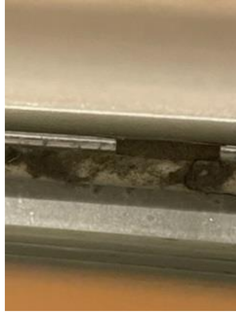
Mynd 10 Óhreinindi bak við ofn í skólastofum, erfitt að framkvæma þrif á þessum stöðum.
