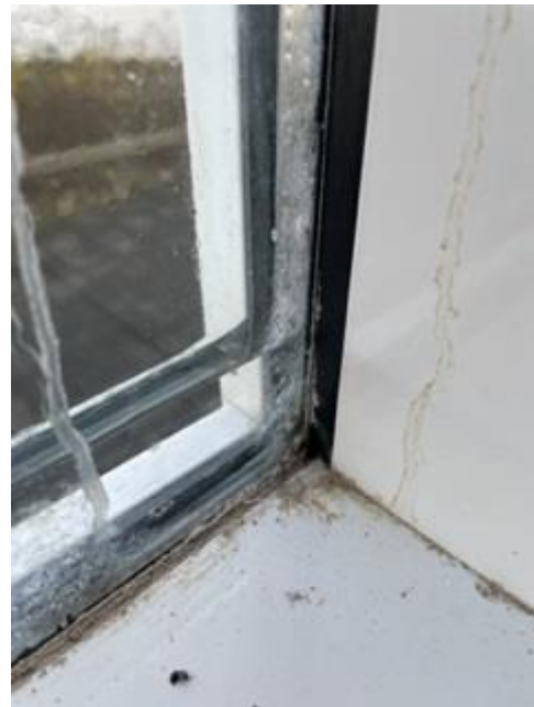
Mynd 4 Rúða sem er að fyllast af vatni í stofu 109.
