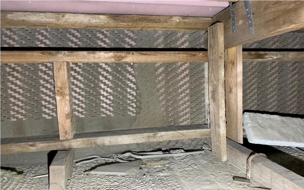
Mynd 29 Rakasperra fallinn niður.
