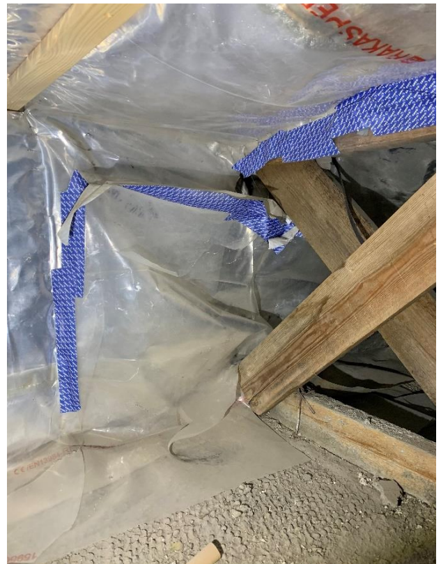
Mynd 17 Ófullnægjandi frágangur á rakasperru.
