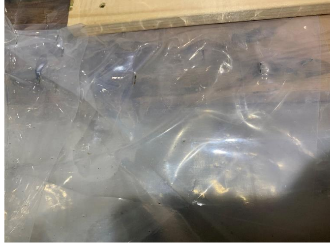
Mynd 16 Dekking á bita bakvið sperru, mygla möguleg.
