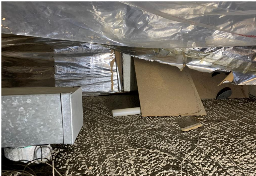
Mynd 34 Mikið los á raksperru.
