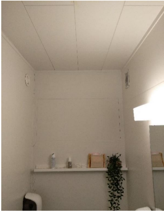
Mynd 44: Snyrting í H-3. Útloftunarrör úr ræsti og inntaksrými liggur yfir á klósett. Ráðlagt að leggja það alla leið út.
