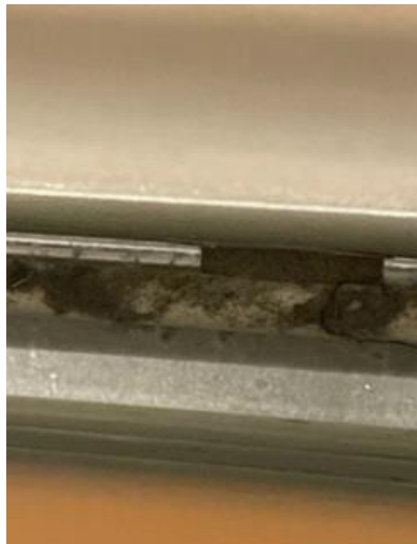
Mynd 47: Óhreinindi bak við ofn í skólastofum, erfitt að framkvæma þrif á þessum stöðum.
