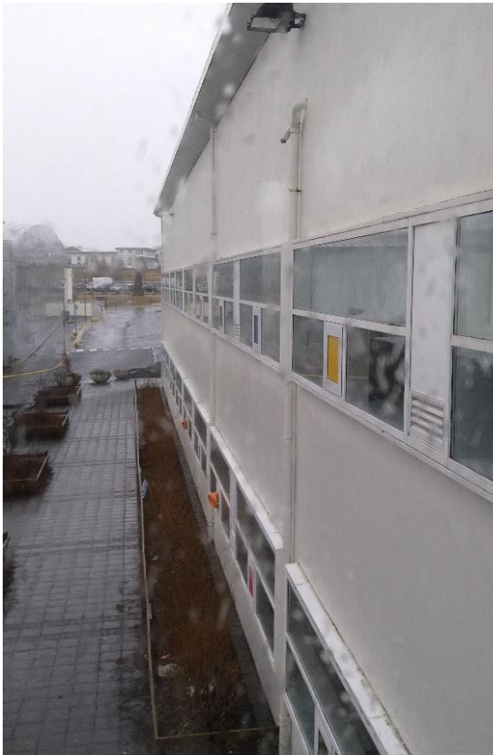
Mynd 24: Niðurfalls rör notað sem lagnastokkur
