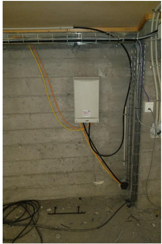
Mynd 25: Niðurfalls rör notað sem lagnastokkur fyrir ljósleiðara
