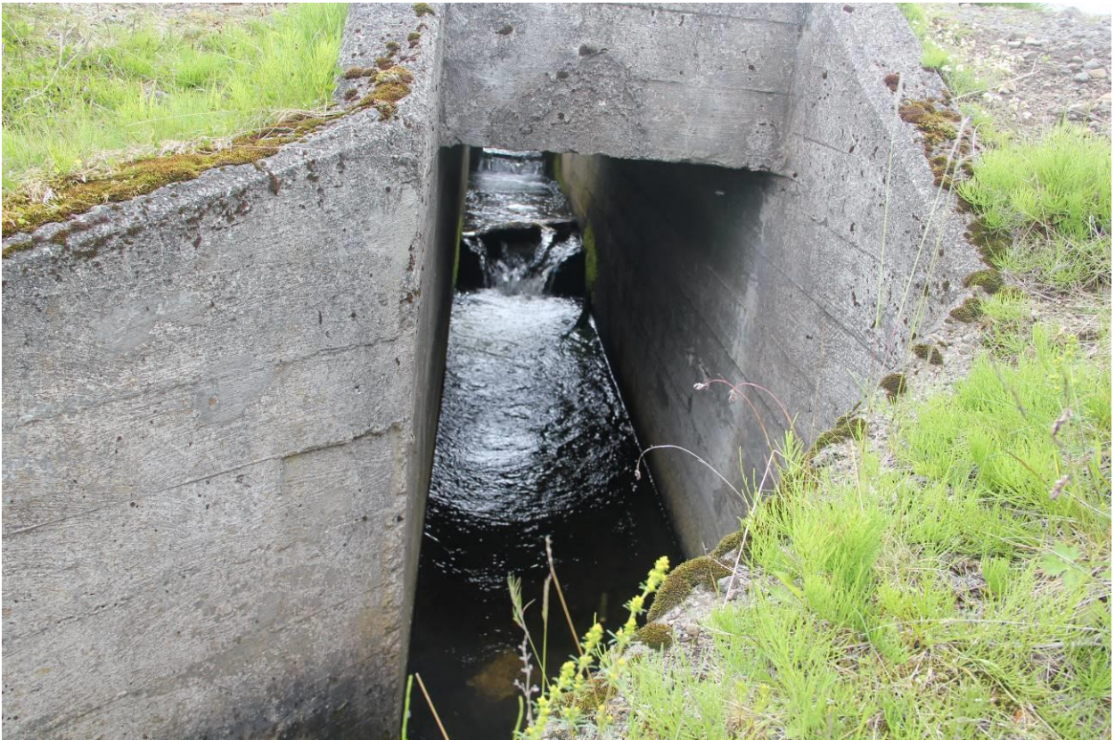
Mynd 10. Fiskistigi við útfall frá Urriðavatni. Horft til suðurs neðan við fiskistiga.
