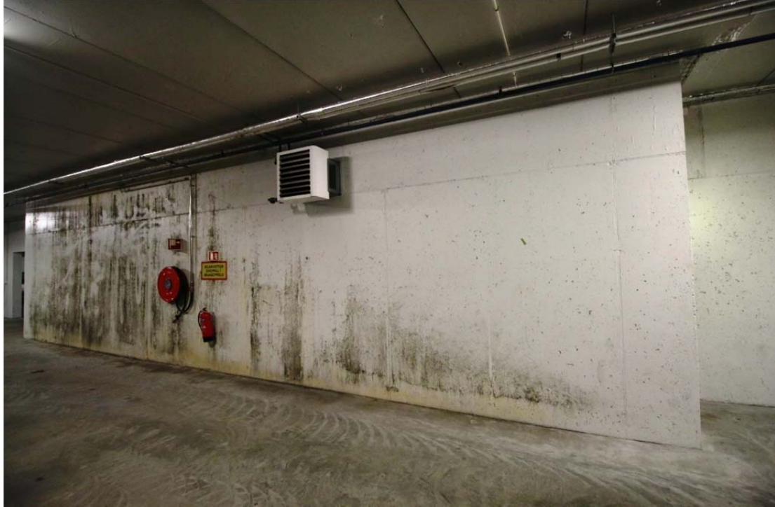
Mynd 3.1.2. Óhreinindi og sót sem safnast fyrir vegna rakaútfellinga á vegg í bílageymslu.
