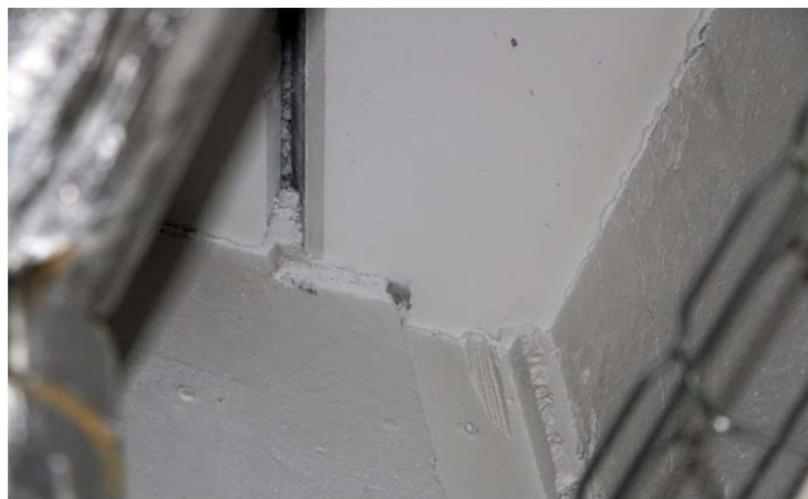
Mynd 3.1.1 Lek samskeyti milli þakplötu bílageymslu og aðalbyggingar
