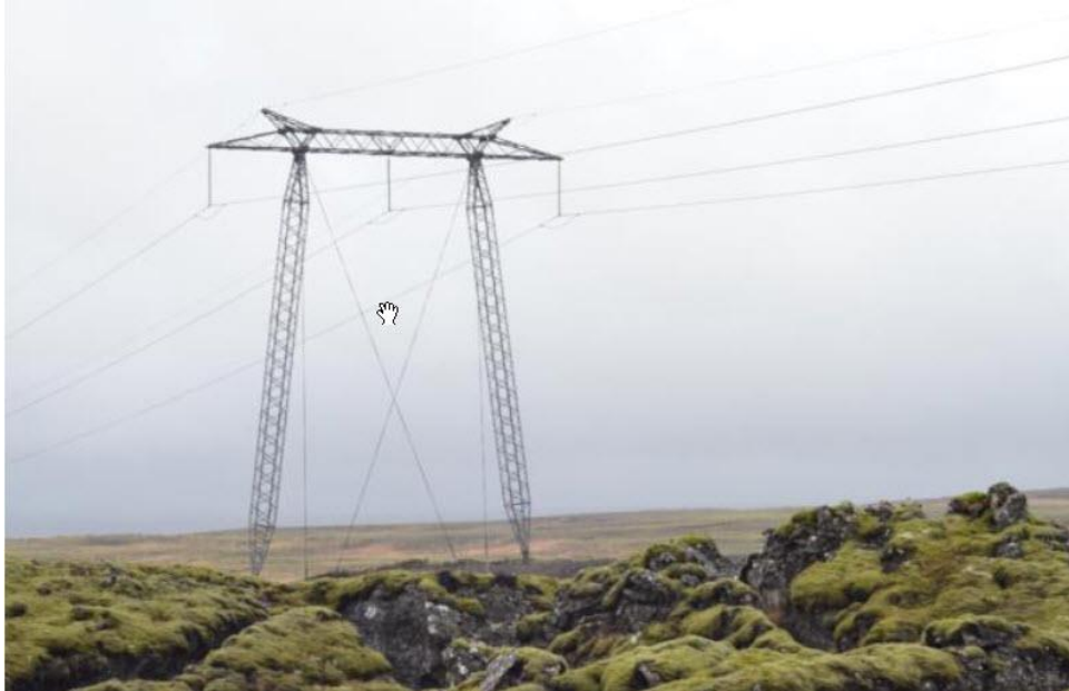
Mynd 6.1 Mastur í Búrfellslínu 3b, stagað stálgrindarmastur.
